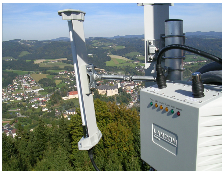
Der 11n-Outdoor-Access-Point Lancom OAP-310agn Wireless im Außeneinsatz.
